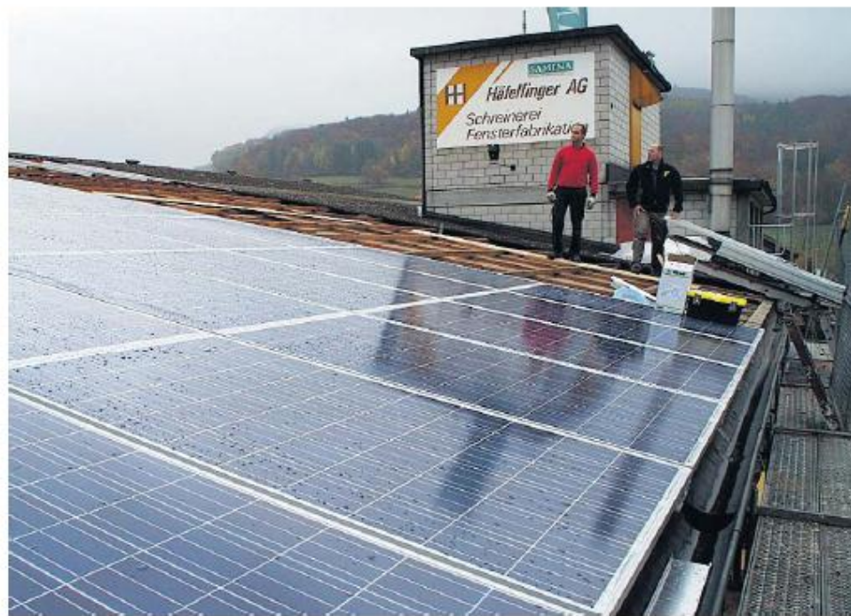
Die Photovoltaikanlage produziert Strom und fungiert auch als Dach.
